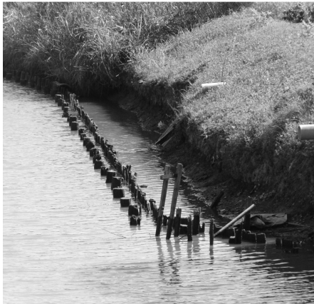
写真2 クリーク崩壊状況
