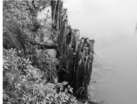
写真6 池周囲土留め木杭の腐朽事例
