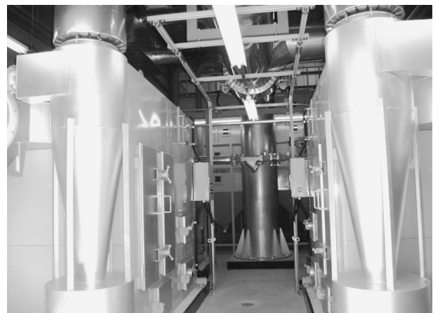
写真6 役場庁舎に設置されたペレットボイラー室 （上）とボイラー2基（下）
