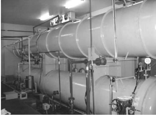
エコアコールウッド注入管設備
