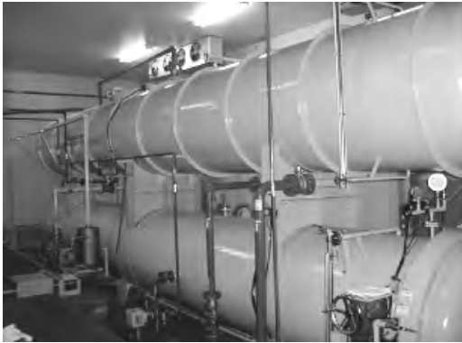
エコアコールウッド注入管設備
